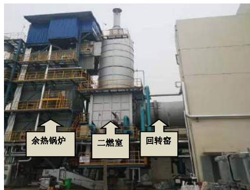
回转窑+二燃室+余热锅炉
