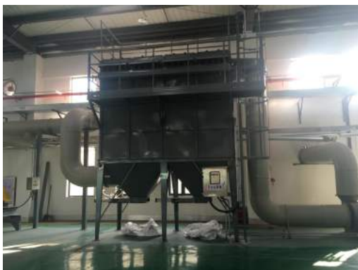
固化车间除尘装置
