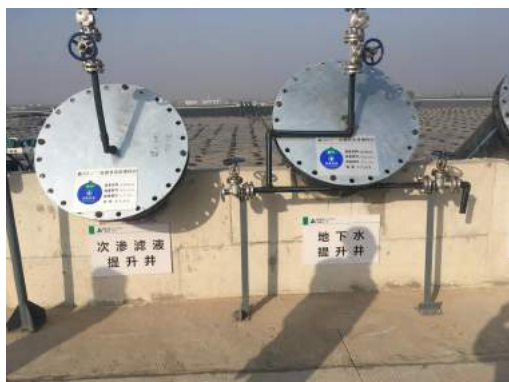
次渗滤液、地下水提升井
