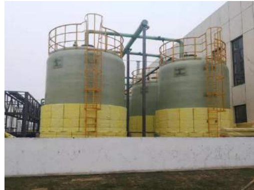
物化废液罐区围堰
