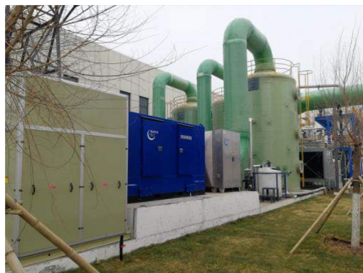
物化及资源化除臭区
