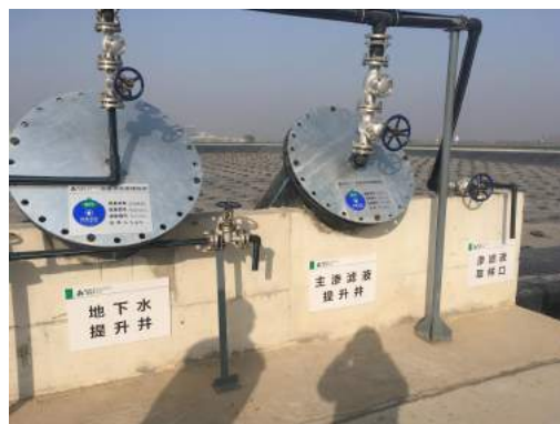
主渗滤液提升井和渗滤液取样口
