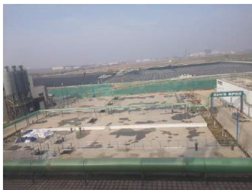
综合水池（包括渗滤液调节池、事故水池和初期雨水池）
