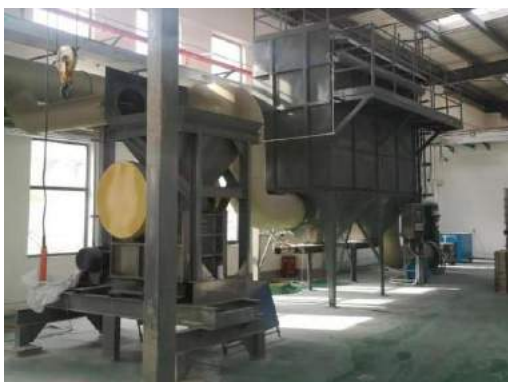
破碎机和除尘装置
