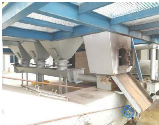
焚烧残渣处理
