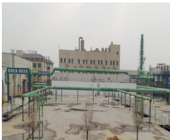
综合水池废气收集管道
