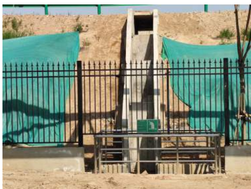
填埋场雨水排口 2
