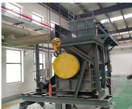
固化车间袋式除尘器
