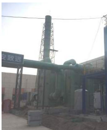
物化及资源化系统废气排气筒
