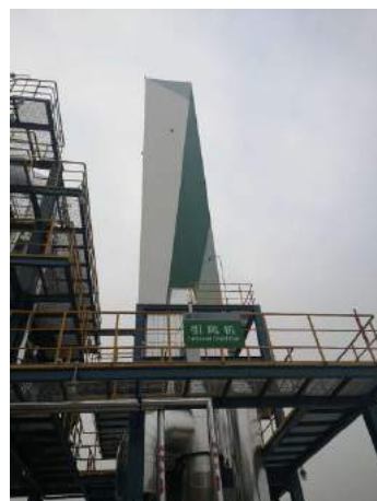
焚烧线排气筒
