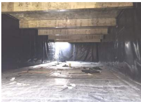
综合水池 HDPE 膜
