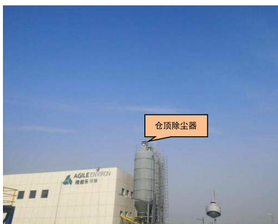
储仓仓顶布袋除尘器
