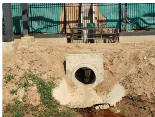
填埋场雨水排口 3
