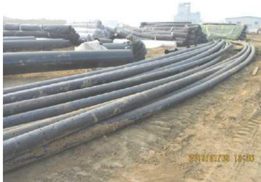
地下水及渗滤液倒排管
