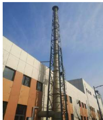
固化车间废气排气筒
