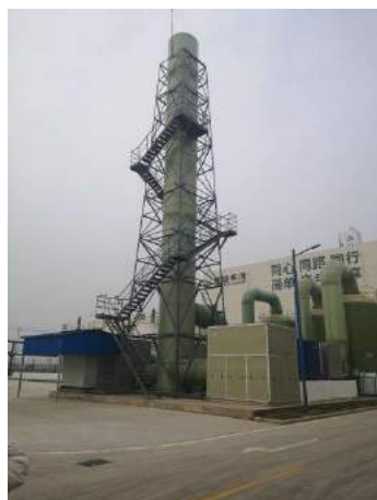
暂存库及料坑废气排气筒
